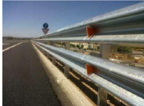
TD-2 Barrera de seguridad metálica
